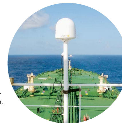
ANTENNE: Für den Uplink auf den Satelliten werden auf Kosten des Providers eigene Antennen installiert, um den normalen Datenverkehr nicht zu beeinträchtigen.
